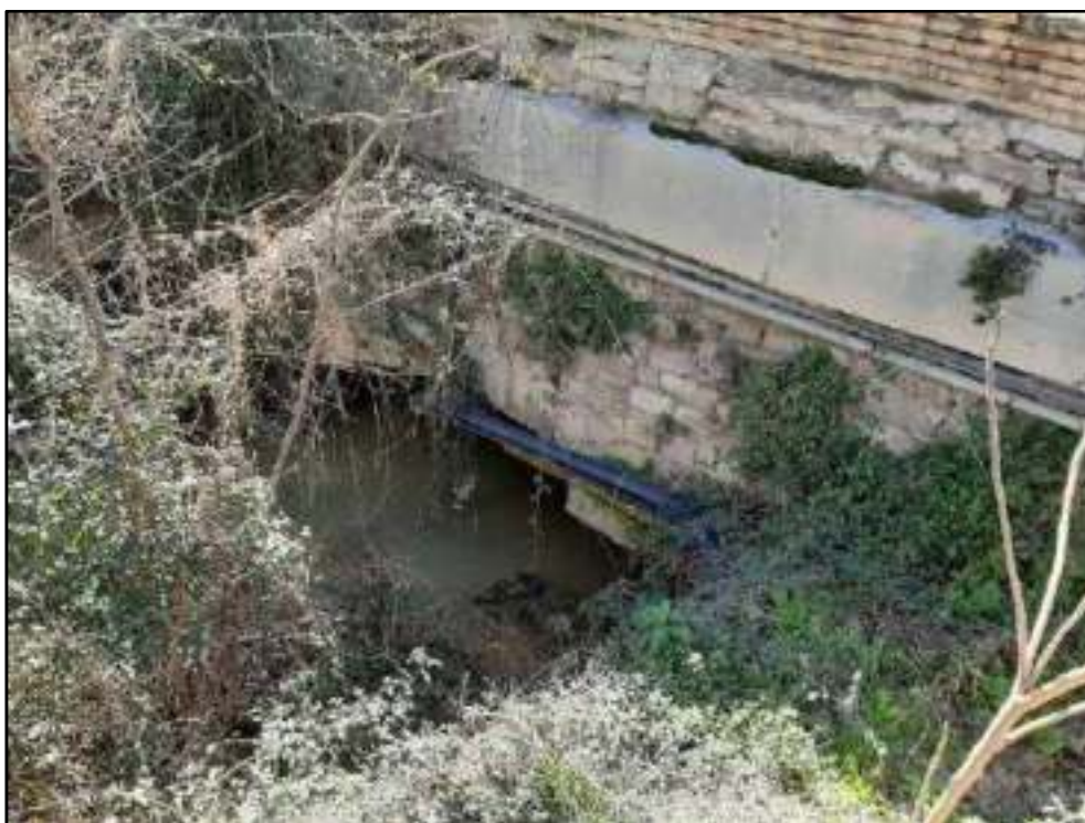
Ilustración 46. Vistas de la compuerta que regula la salida del caudal del barranco Mediavilla al cauce del Ebro. En este punto, al igual que en la salida del Queiles, se ha instalado una compuerta flotante, que se levanta al crecer el caudal del Ebro, evitando el retorno de estas aguas hacia las calles del casco viejo.
