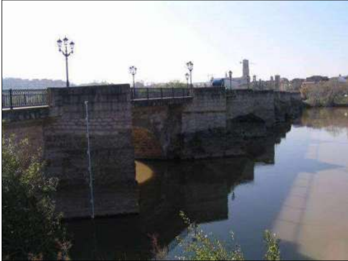
Ilustración 10. Fotografías de la estación de aforo del río Ebro situada en el término municipal de Tudela. Imágenes obtenidas de la página web del SAIH de la Confederación del Ebro.
